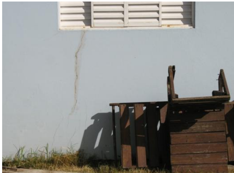
Figura 3: Rachadura encontrada em uma das moradias do Loteamento Cidade de Águeda. Fonte: Foto do autor, dez. de 2009.
