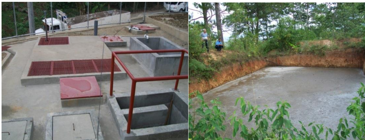
Foto 03. Adecuación de sistemas de tratamientos de cargas contaminantes Sistema de tratamiento para aguas residuales.
