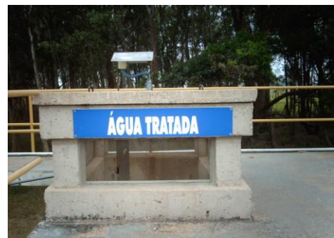
Figura 3.4: Tanque contendo a água tratada
