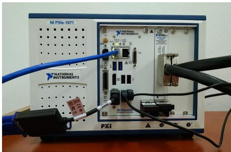
Figura 24: Módulo ADC NI PXIe-6363 (slot onde estão sendo conectados os dois cabos pretos), conectado ao PC NI PXIe-8135.
