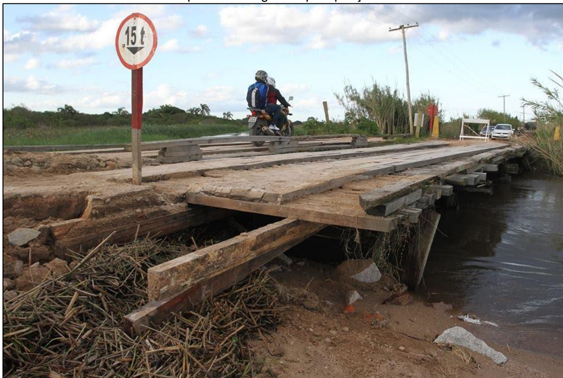
Figura 46: Ponte da estrada de acesso, desembocadura do canal Reasilva que não consegue dar vazão em períodos de grande precipitação.
