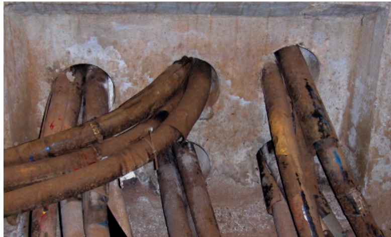
Figura 1.1: Galeria de distribuição subterrânea da CEEE.
