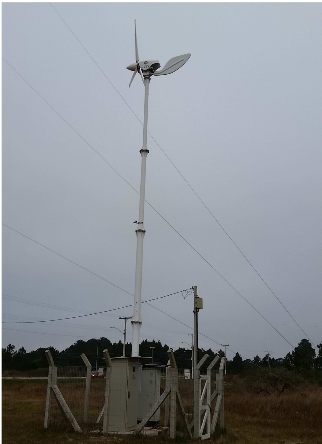
Figura 5-3 – Aerogerador ZM Bombas modelo 3kW em funcionamento. Foto: R. Zanotta (07/2017).
