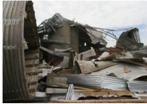
Figura 3.7.- Estruturas de Ferro não resistiram vendaval Fonte: Marcus Maciel, DP, 2014
