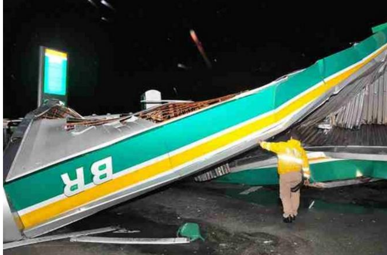
Figura 3.9. - Telhado de posto de gasolina desaba com força do vento
