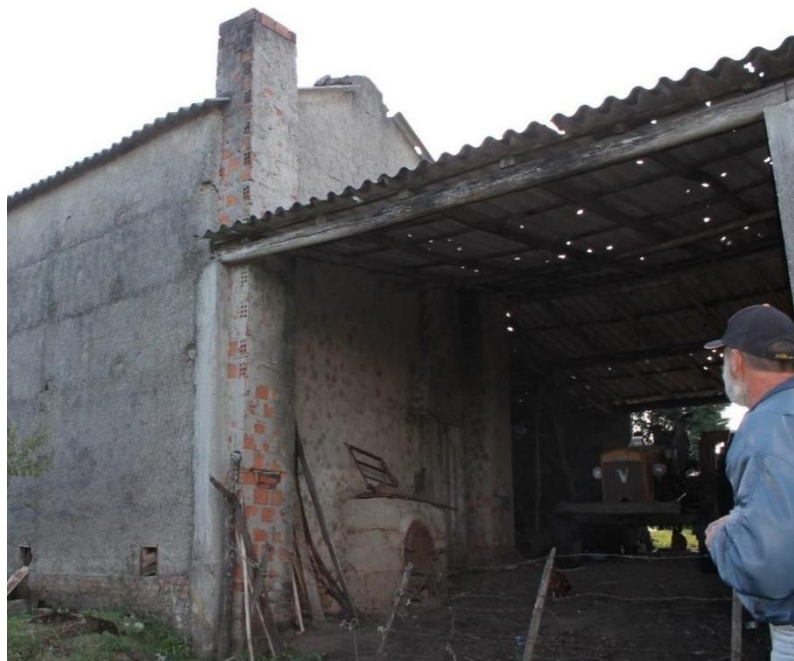
Figura 17 – Registro dos furos no telhado do galpão de Sidinei devido à chuva de pedras.
