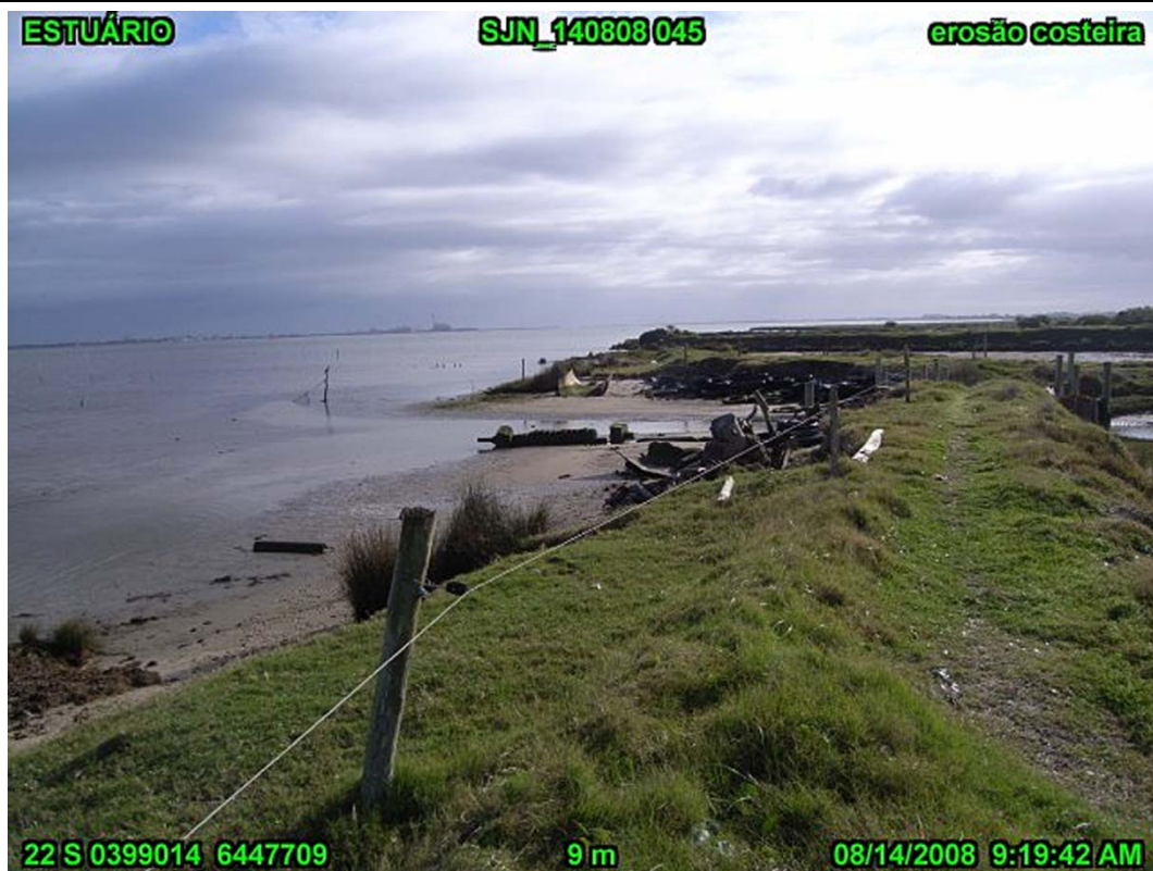
Figura 4. Foto georreferenciada de área em processo erosivo com proteção parcial de pneus, costa leste.
