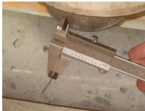
Fig. 3.29 – Fissura com abertura de 1 mm.
