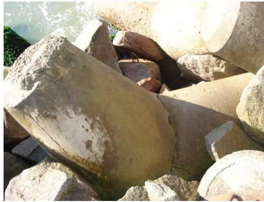
Fig. 2.25 – Blocos rachados com pedras e limo (MIGLIORINI, 2007).
