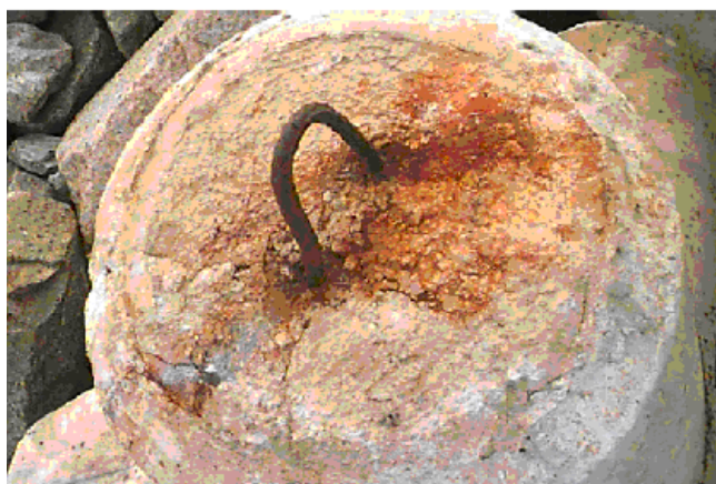
Fig. 2.21 – Fissuras junto à barra de aço. (GUIMARÃES, et al., 2003).
