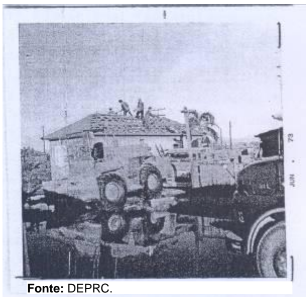
Figura 5: Trabalhadores retirando telhas de casa a ser removida, e posteriormente puxada pelo trator.
