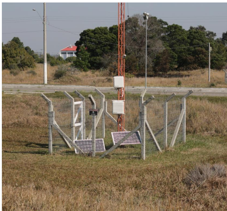
Figura 3.1.6 - Base da torre, compartimentos de armazenamento da bateria e datalogger (Fonte: Ribas, 2017).
