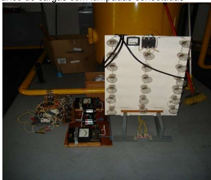
FIGURA 6.26 – Banco de cargas com lâmpadas conectadas
