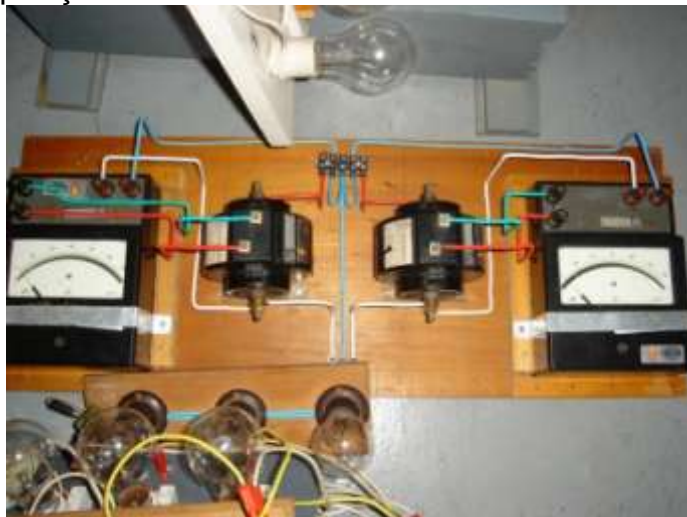
FIGURA 6.27 – Disposição dos wattímetros e transformadores de corrente
